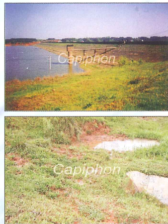
◀ (中国) 貯水池が嚴重な水漏れと浸透で貯水量が非常に少ない状態。施工現場。
