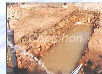
◀ 施工前の源水 (海水)
